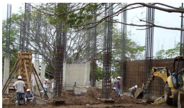
Imagen de Avance en la construcción del edificio de posgrado y educación a distancia
